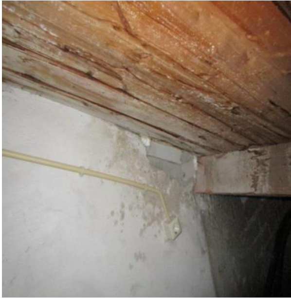
Figuur 107 Opening in wandconstructie is dichtgezet met metselwerk. Bron: Foto NRI N141127D.001/1682 23-11-2015
