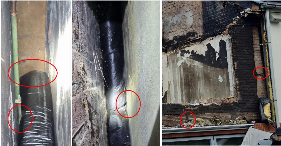
Figuur 78 Twee foto's van ingesealde glaswol verticaal in de spouw, rechts roetaanslag die duidt op openingen tussen de glaswol
