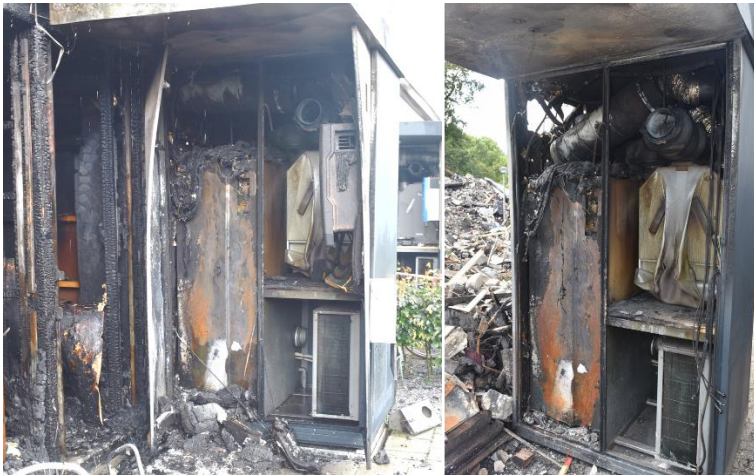
Figuur 59 Links: energiemodule aan woning nr. 44 vast, rechts: de veiliggestelde energiemodule
