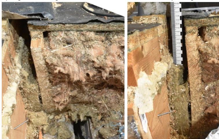
Figuur 103 Isolatie bij de aansluiting dakelementen ter plaatse van de woningscheidende wandconstructie
