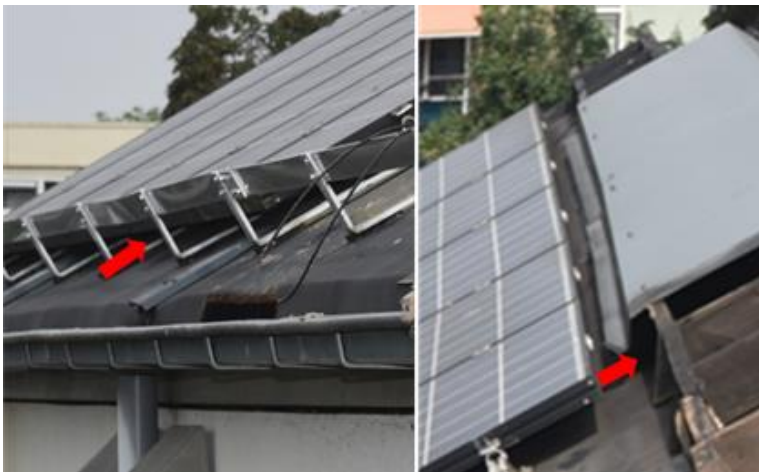
Figuur 67 Route van vlammen onder zonnepanelen naar nok van het dak
