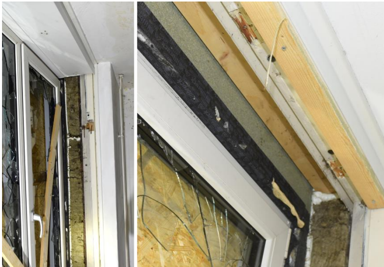
Figuur 76 Spouw aan de bovenzijde van het kozijn van de keuken
