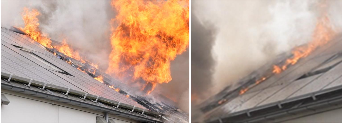
Figuur 68 12:10-12:12, Linker- en rechterzijde voorkant dak woning nr. 44. Vlammen komen onder zonnepanelen vandaan. Bron: Heitink/Gelrenieuws.nl
