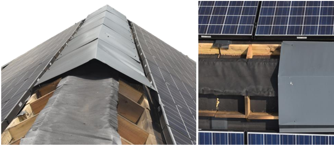
Figuur 14 Nokconstructie waar een deel van de afdekkappen vanaf is gehaald.
