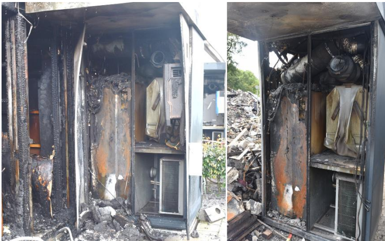
Figuur 27 Links energiemodule aan woning nr. 44 vast, rechts de veiliggestelde energiemodule
