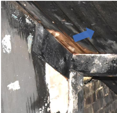
Figuur 85 Locatie van aanvoer lucht en de lokale beperkte aantasting
