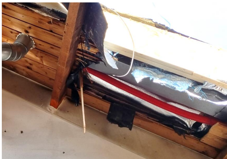
Figuur 101 Ventilatiekanaal en buis met kabels PV-installatie in dakconstructie
