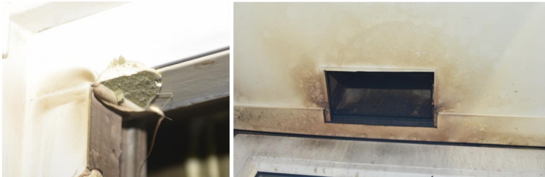
Figuur 80 Links rookverspreiding langs de aftimmering bij het kozijn en rechts langs de opening bij het ventilatiekanaal
